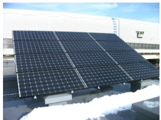
屋上に設置した太陽光パネル
