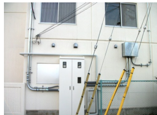
外部低圧引込盤
